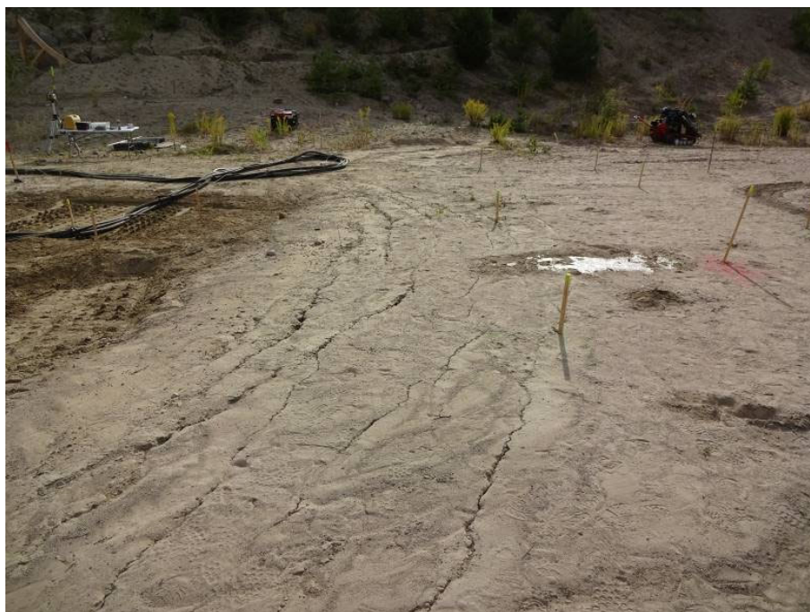
Figur 35. Sprickor på markytan till följd av packning.
